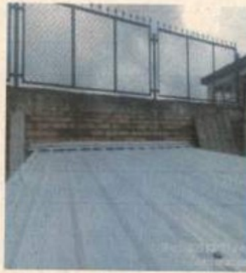
Teja para centro de acopio.
